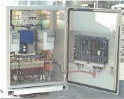
Figura 11. Caja de control local del heliostato Colón-70 con la tarjeta GA2696A desarrollada por Ciemat
